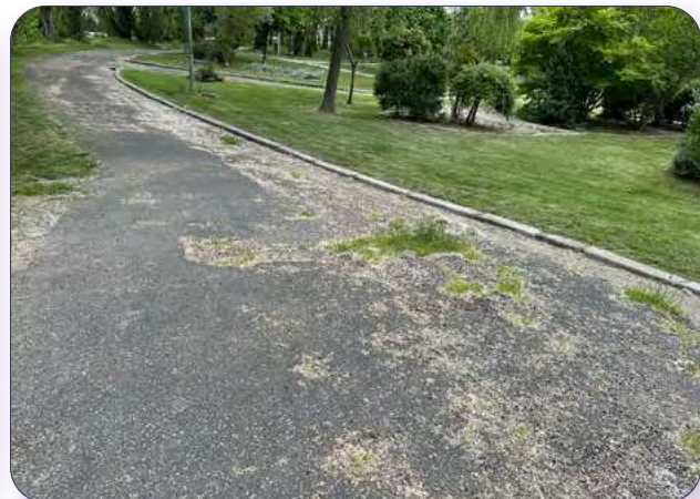
Pavimento irregular en la zona del Parque de la Isla.
